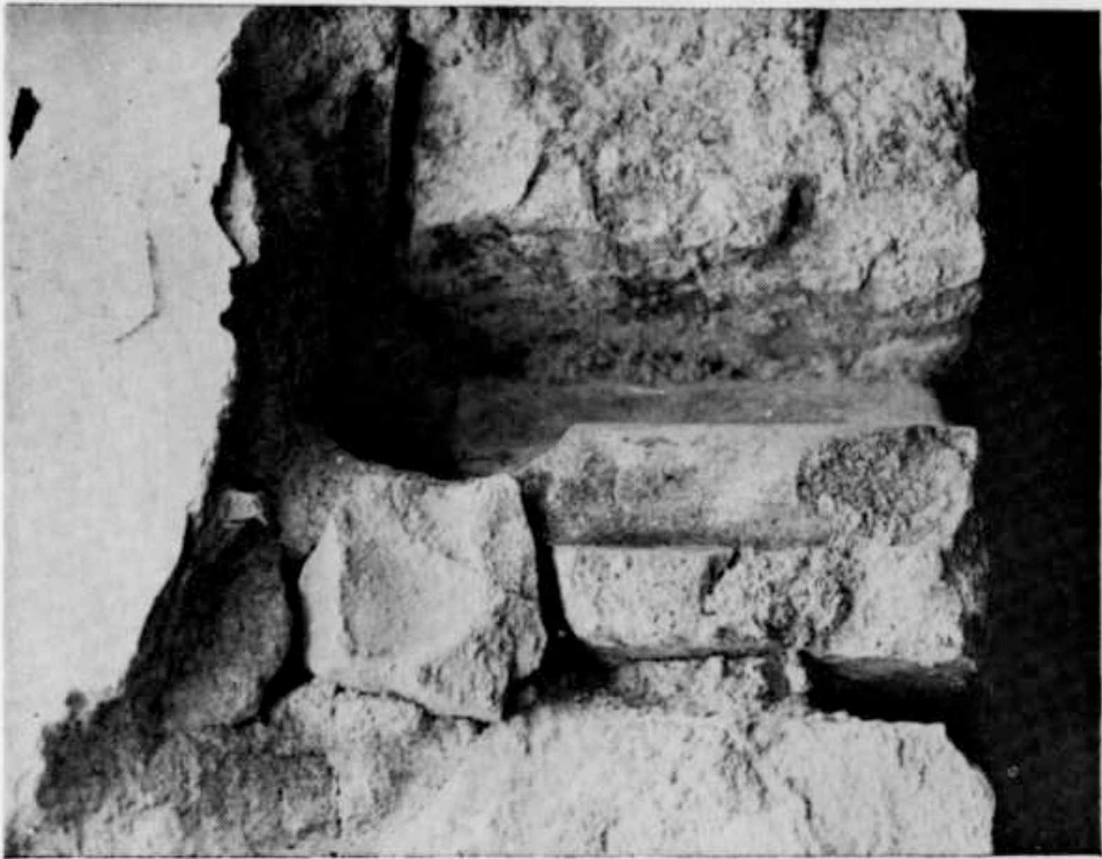
Meneau et fragments d'imposte noyés dans la maçonnerie XIX e siècle
