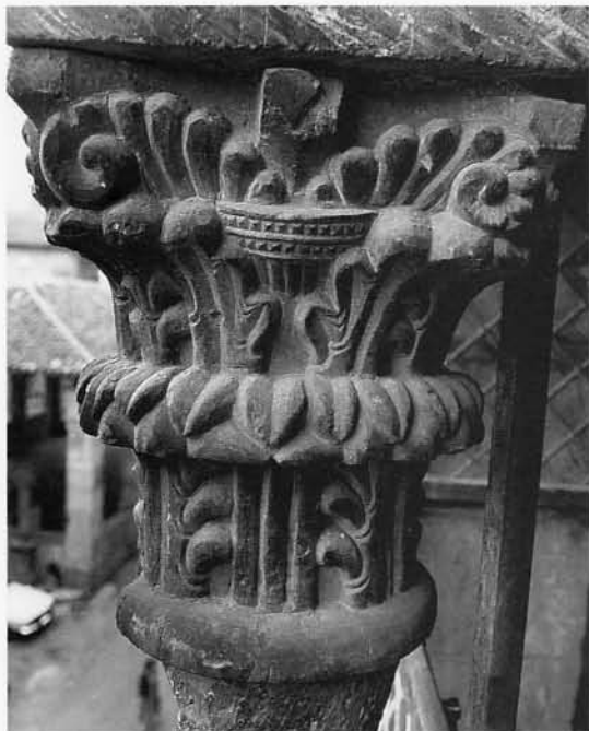
FIG. 42 - CORPS PRINCIPAL : CHAPITEAU DE LA FENETRE CENTRALE DU 2 e ETAGE (Cl. J.-F. Peiré / C. Soula, Inventaire Général).
